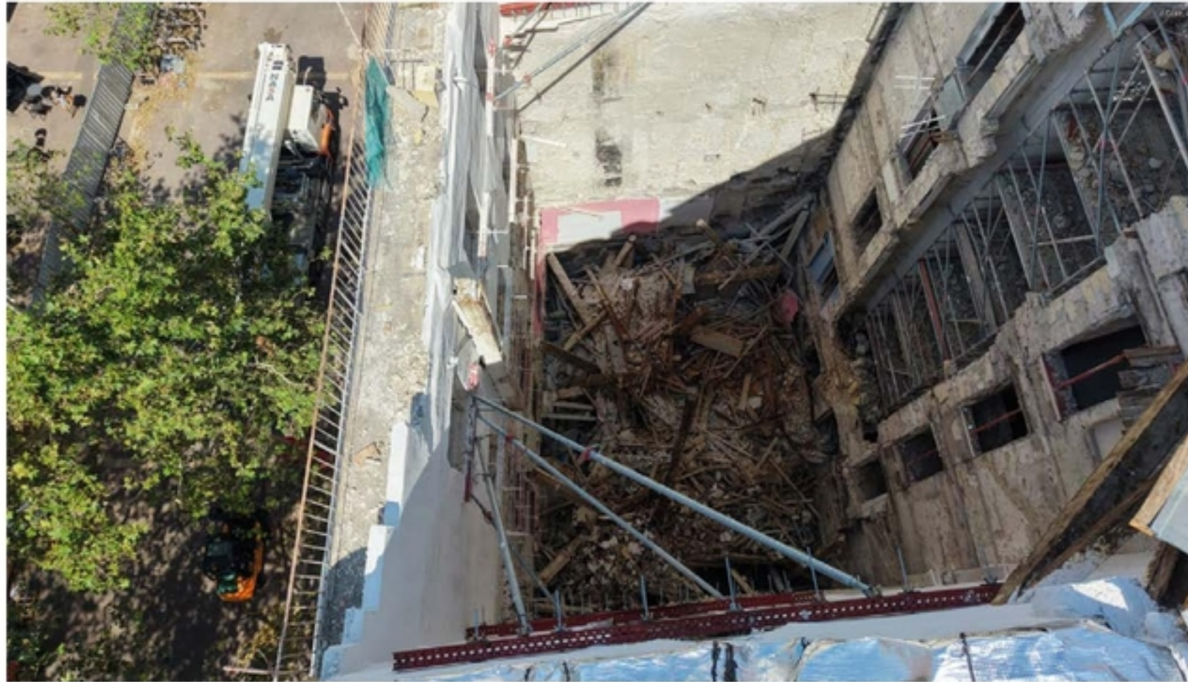
Une image vue du ciel de l'immeuble effondré le 18 juin 2026 à Noailles, prise par drone par des riverains. PHOTO DR
