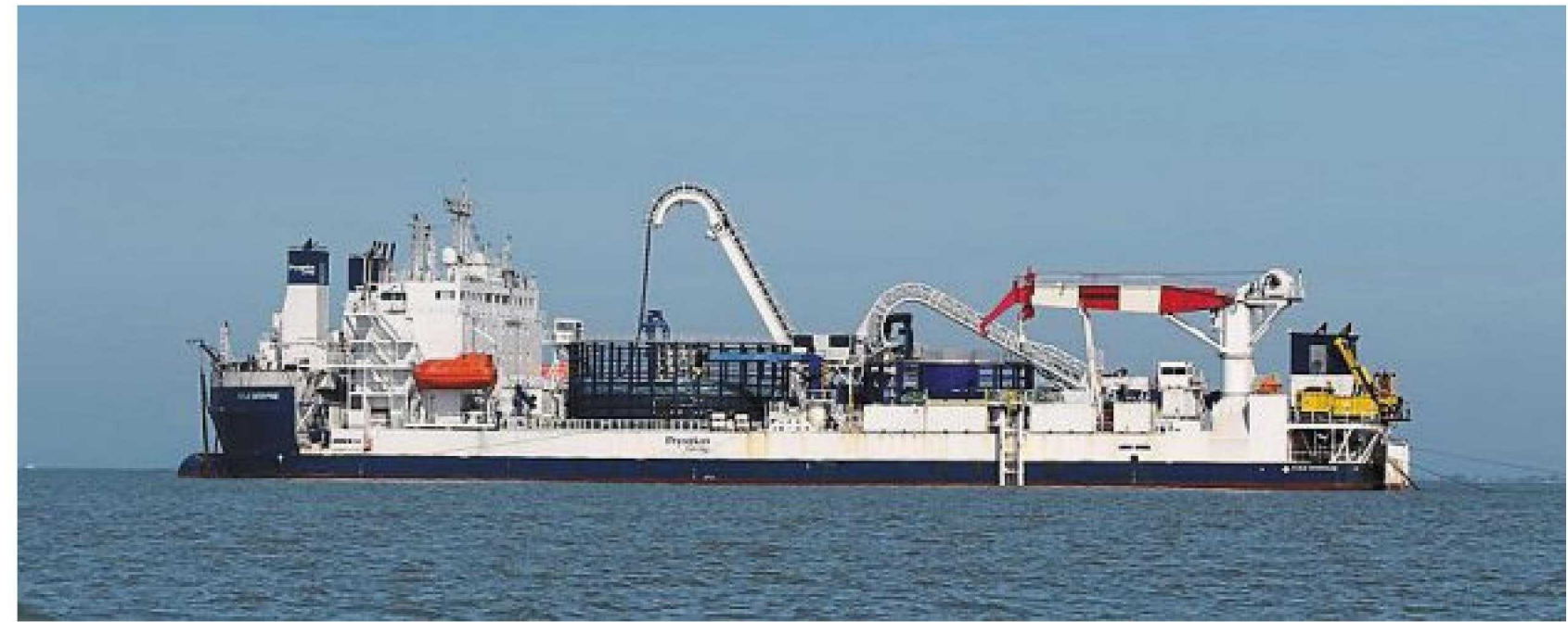
Le « Cable Entreprise » transporte un câble de 27 kilomètres, qu'il dépose dans les fonds marins, pour le raccordement du futur parc éolien Yeu-Noirmoutier.
